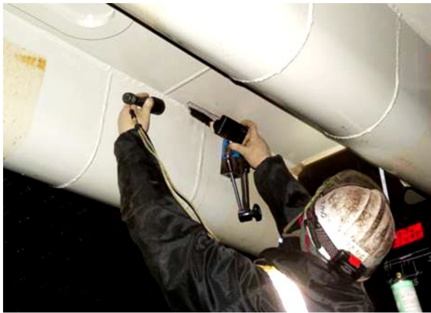
①橋梁点検で鋼製床版・桁等に損傷(亀裂)を確認。
