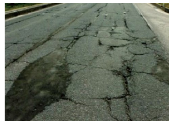
アスファルト舗装ひび割れ
