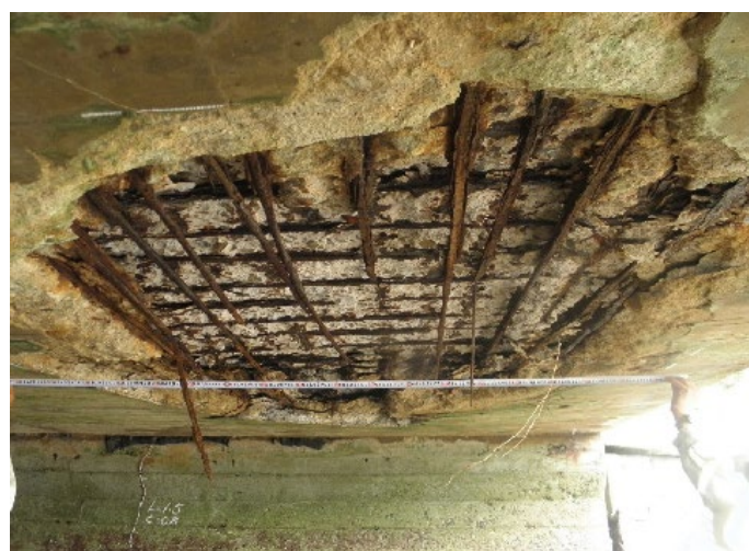
床版鉄筋露出
