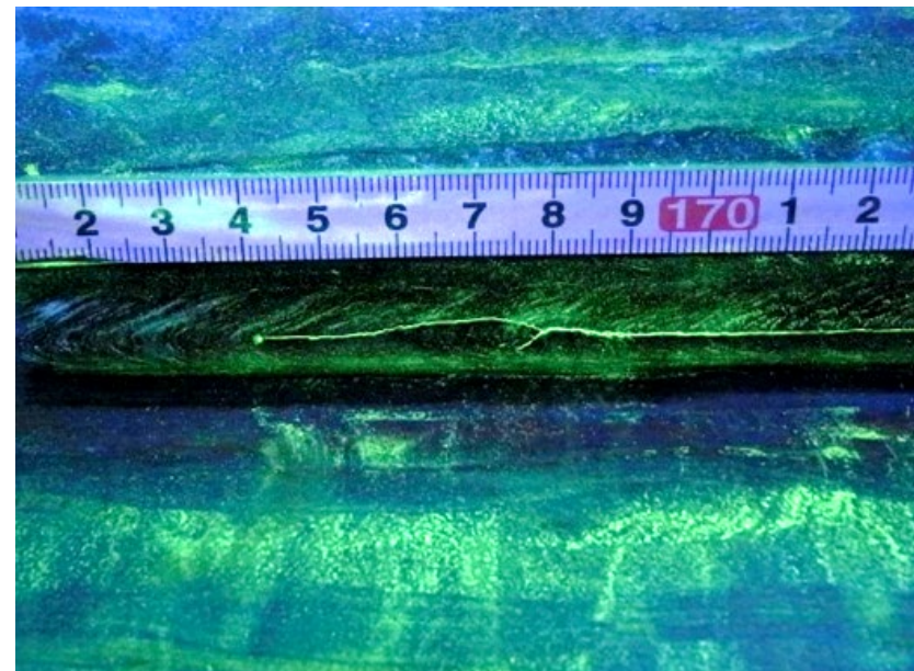
②損傷要因を「疲労」と特定するとともに、早期に補修が必要と診断。
