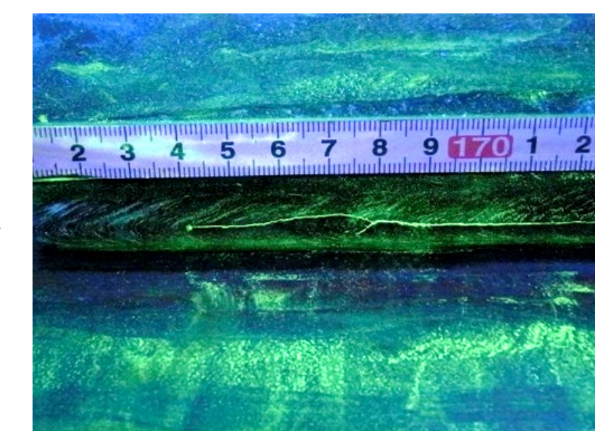
②損傷要因を「疲労」と特定するとともに、早期に補修が必要と診断。
