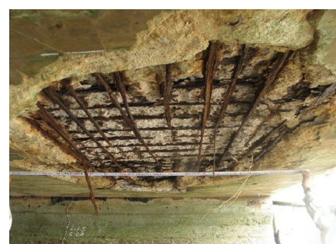
床版鉄筋露出
