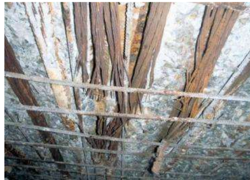
PCケーブルの損傷状況
