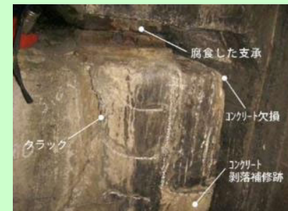
ゲルバー部の損傷
