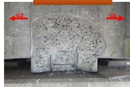
上部工の破損
