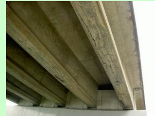
不十分なグラウトに起因する主桁下フランジのひび割れと漏水、エフロレッセンス
