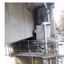
④A2橋台 箱桁端部付トブブロック 横変異装置の損傷
