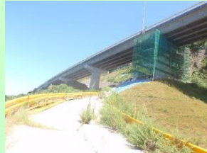
多径間ポステント桁橋
