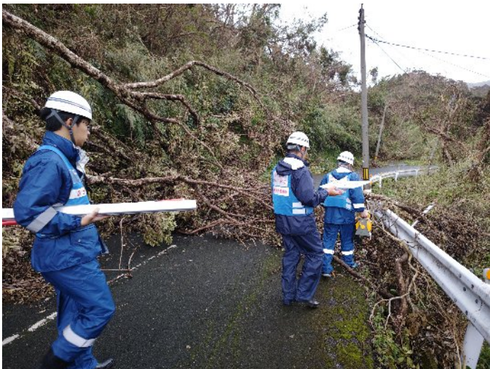
調査中の被災状況調査班(道路)
