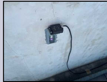
▼傾斜計（現地設置状況）
