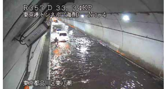
冠水状況 令和7年9月11日(国道357号 東京港トンネル 品川区)
