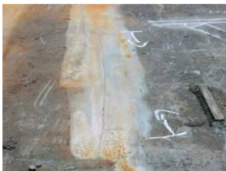
デッキプレートの疲労き裂
