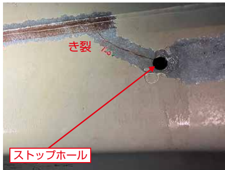
Uリブの疲労き裂補修としてストップホールを設置
