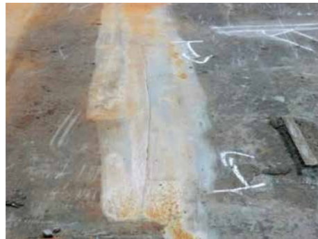
デッキプレートの疲労き裂
