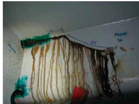
縦リブと横リブの交差部付近のき裂
