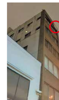
損傷部 拡大写真
