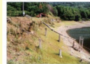
老朽化したため池
