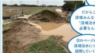
堤防が決壊した様子 ※洪水が落ち着いてから撮影しています
