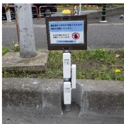
道路浸水センサ設置状況
