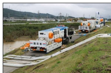
排水ポンプ車の配置状況
