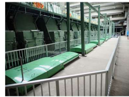
ポンプ所の除塵設備例
