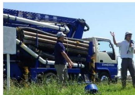
東京都 コンクリート圧送協同組合との訓練 引用: 第2回検討会 東京都資料
