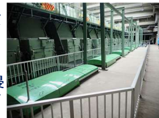
ポンプ所の除塵設備例
