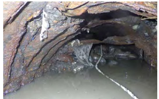
<埼玉県草加市内:コルゲート管内損傷状況>
