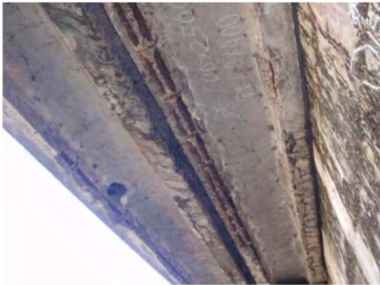
・主桁の剥離・鉄筋露出 <主桁補修>
