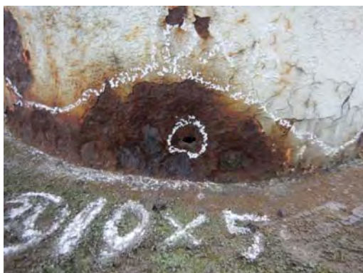
<下部構造(柱部・壁部):腐食>
