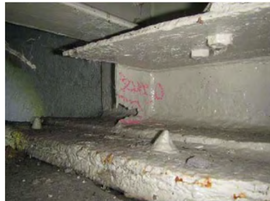
・主桁の腐食 <縦桁補修>
