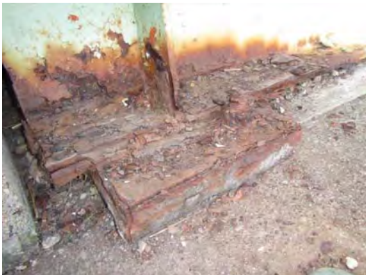
<支承部の腐食>
