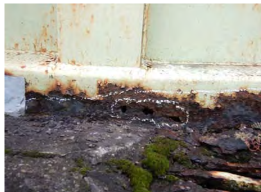
<上部構造(地覆):腐食>
