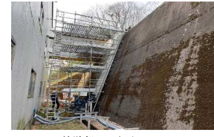
擁壁部のテトリス 成和リニューアルワークス(株) 山崎 公輔
