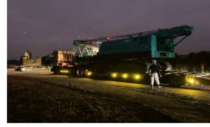
鋼矢板打設の初日、大御所が5時入り! 佐田建設(株) 本多 希望
