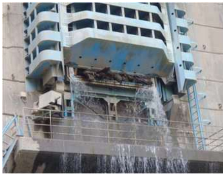
他ダムでの流木によるゲート閉塞例
