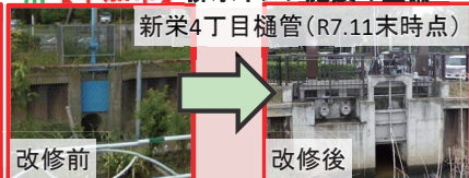
新栄4丁目樋管 (R7.11末時点)
