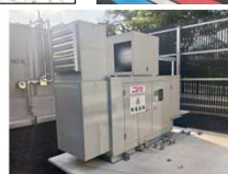
非常用電源（発電機）
