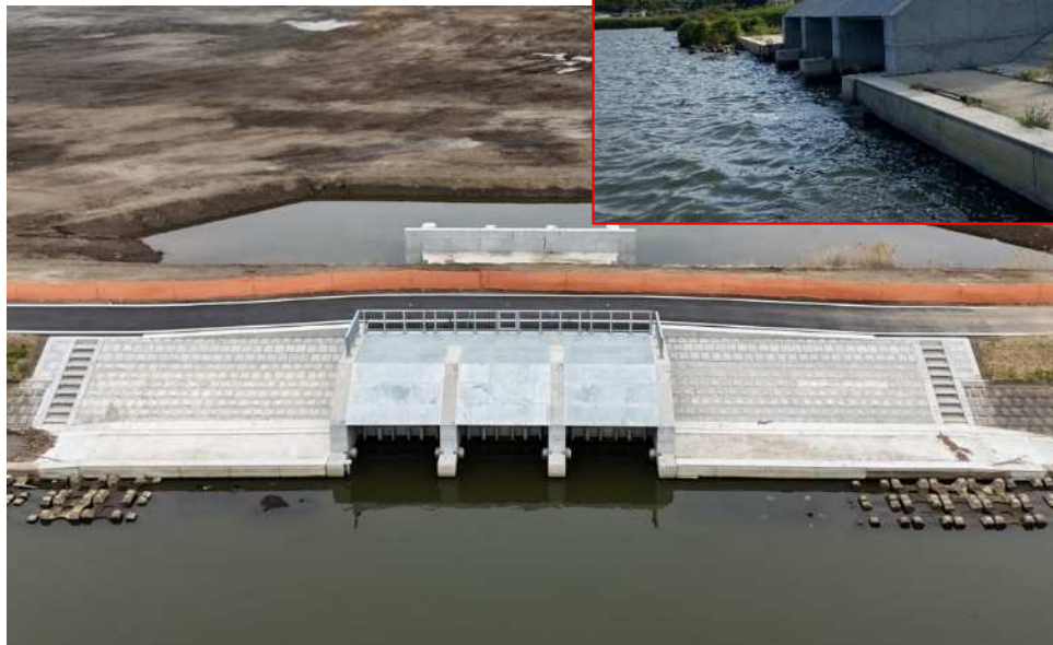
高浜樋管ゲート(門柱レス)
