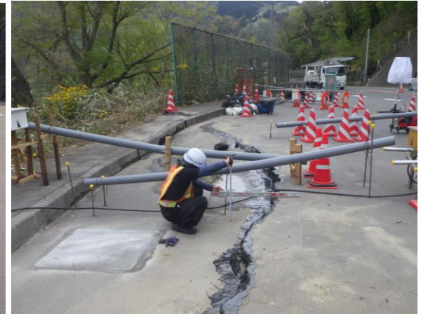
クラック計測の状況(R6.4.23撮影)
