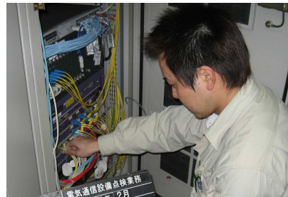
〈通信設備 定期点検状況〉
