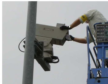
〈CCTV 設備 定期点検状況〉
