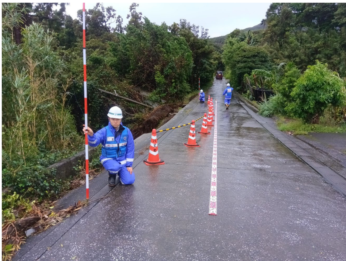
被災状況調査②
