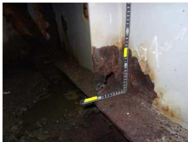
国管理 主桁腐食・欠損
