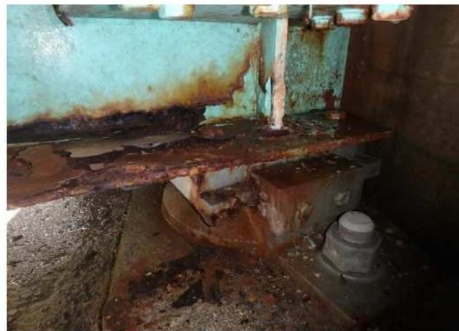
地方自治体管理 主桁腐食
