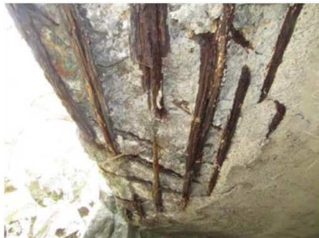
国管理 床版鉄筋露出
