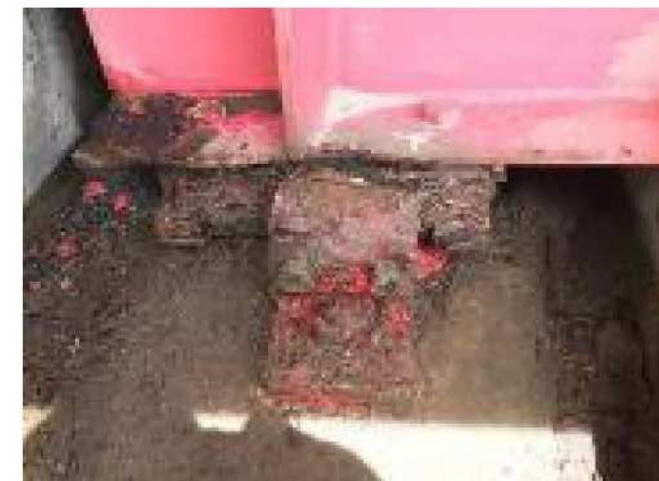
地方自治体管理 支承腐食
