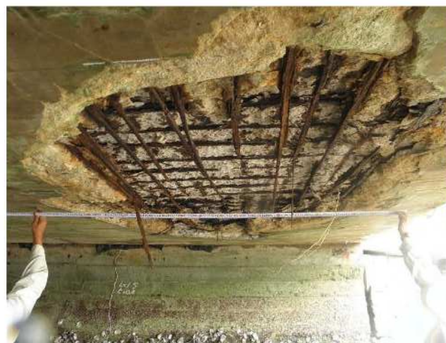
地方自治体管理 床版鉄筋露出
