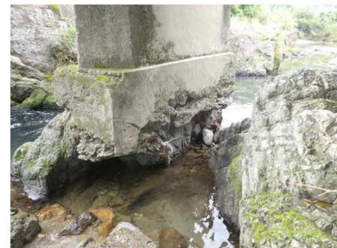
地方自治体管理 橋脚洗掘
