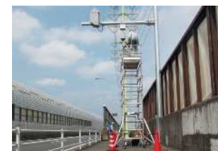
CCTVの設置状況
