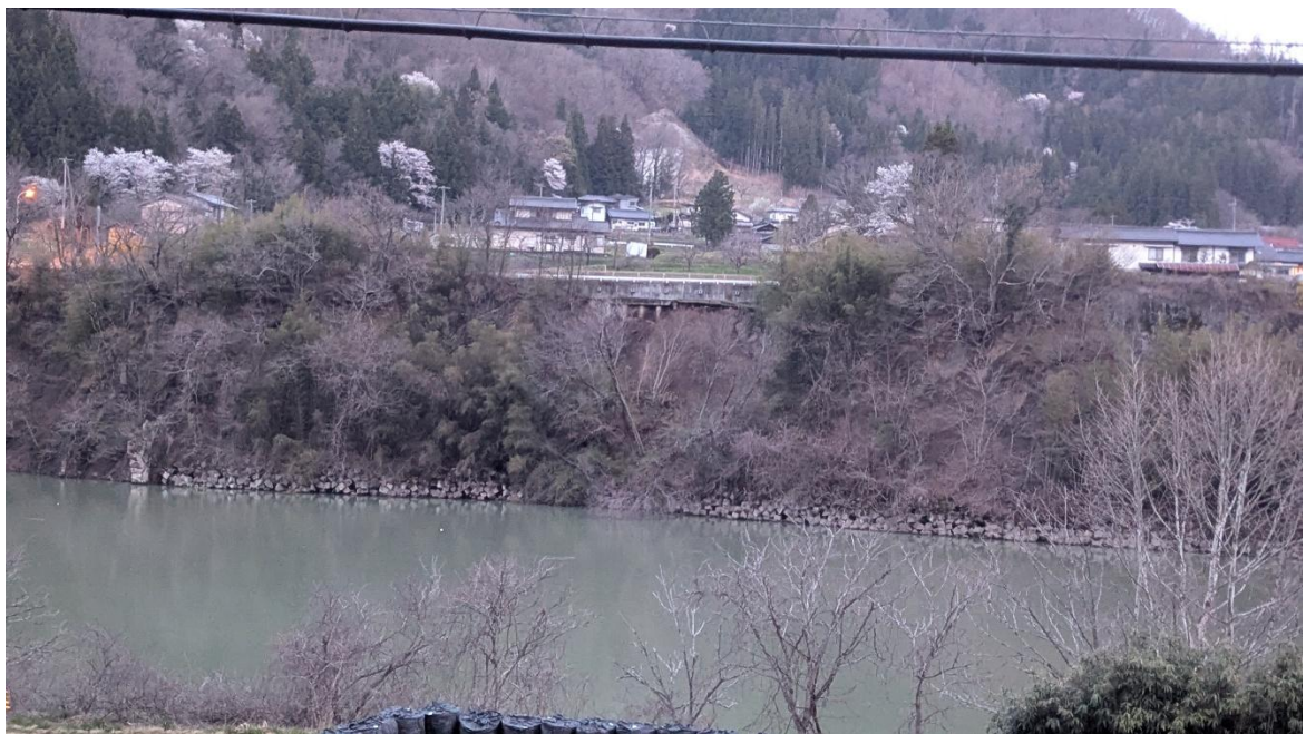
法面崩落箇所の状況：令和7年4月15日撮影
