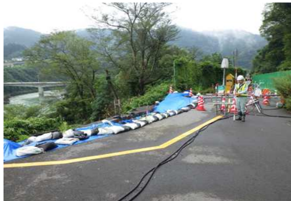
変状監視機器設置状況
