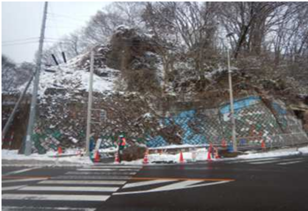
落石発生状況(全景)
