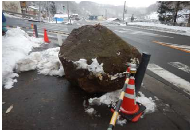
落石発生状況(近景)
