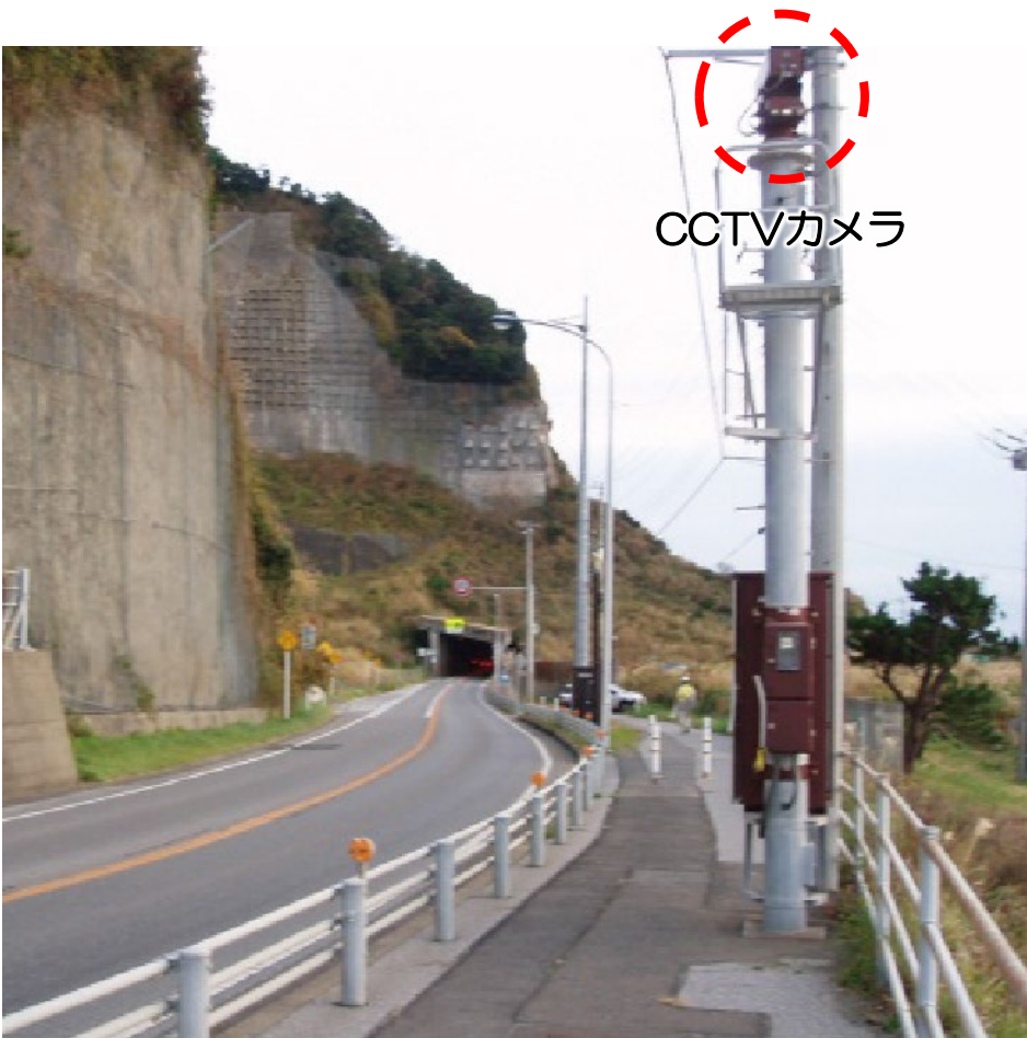
CCTVカメラ設置状況
