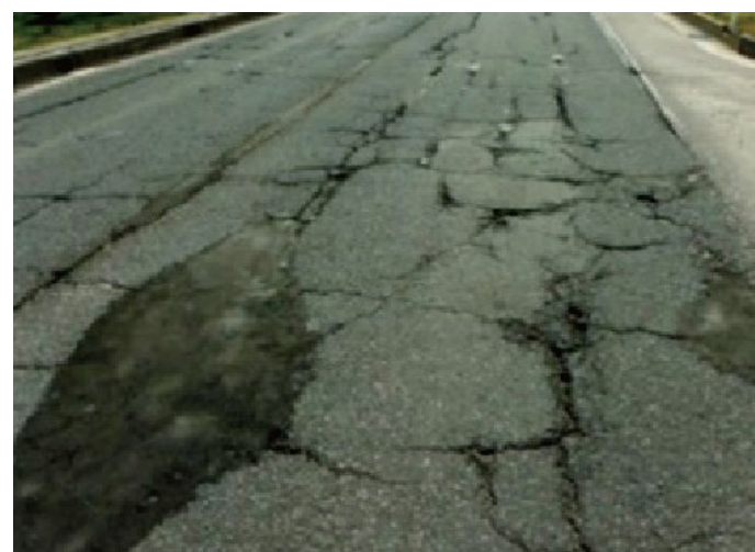
アスファルト舗装ひび割れ
