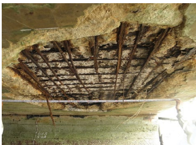
床版鉄筋露出
