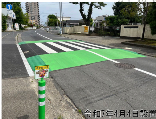
【スムーズ横断歩道設置状況】
