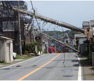
令和元年台風15号による 電柱倒壊状況
