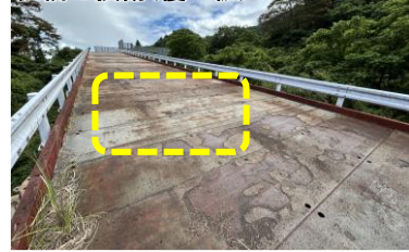
仮橋の損傷(覆工板)
