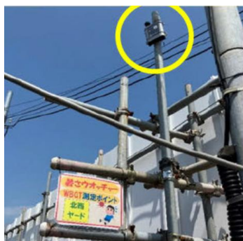
【北西ヤード測定器】
