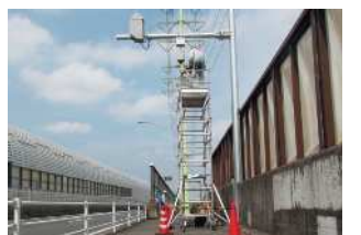
CCTVの設置状況
