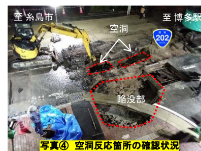
写真④ 空洞反応箇所の確認状況
