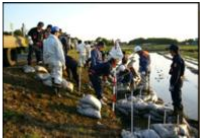
下妻市の漏水の様子（H16.10）
