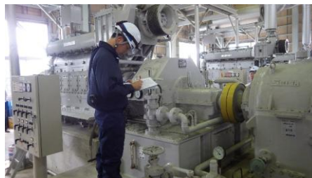
機械設備の点検状況
