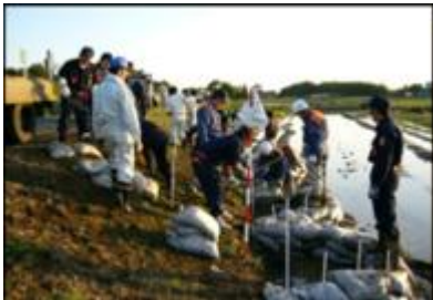
下妻市の漏水の様子 (H16.10)
