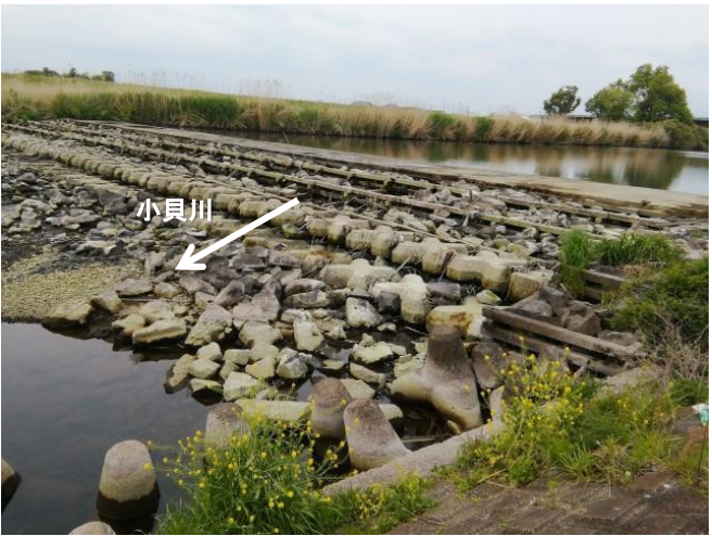
瀬切れの状況 (令和5年4月25日撮影) 徳持堰
