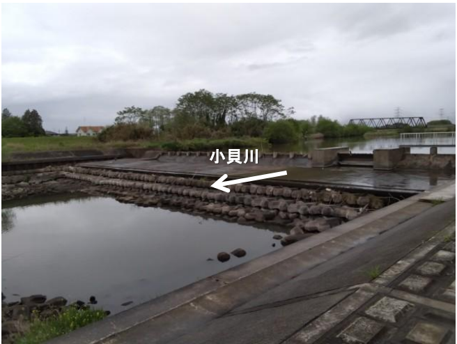
瀬切れの状況 (令和6年4月30日撮影) 村田堰
