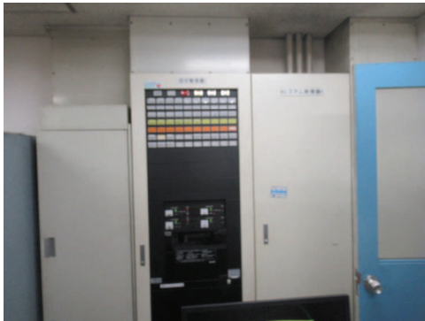
図1 事務庁舎棟（受信機）
