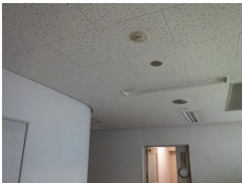
図3 事務庁舎棟（感知器）
