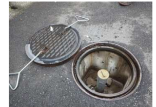
＜通信型水位計設置状況＞
