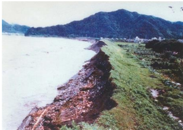
写真 2 昭和 57 年（1982 年）堤防侵食の様子
