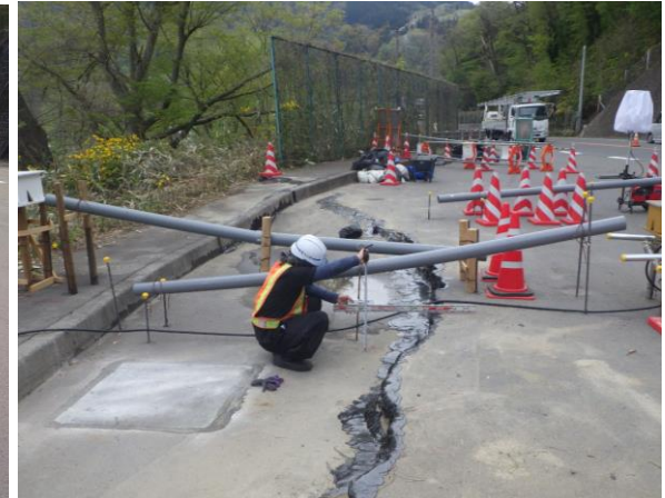
クラック計測の状況(R6.4.23撮影)
