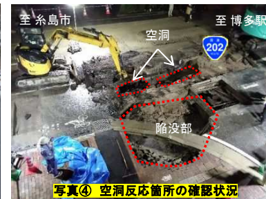
写真④ 空洞反応箇所の確認状況
