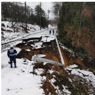
道路被害状況の調査
