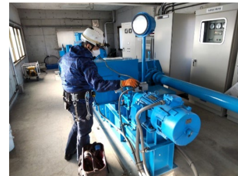
開閉装置の点検
