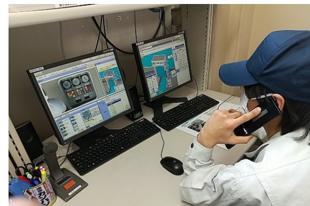
水門等の施設の遠隔操作
