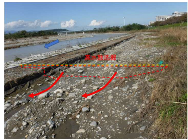
被災状況 (高水敷洗掘)
