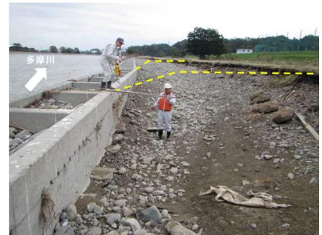
被災状況 (高水敷洗堀)
