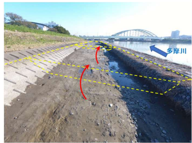
被災状況 (高水敷洗堀)
