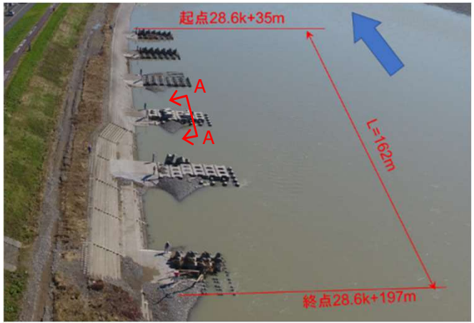
被災状況（水制工流出）
