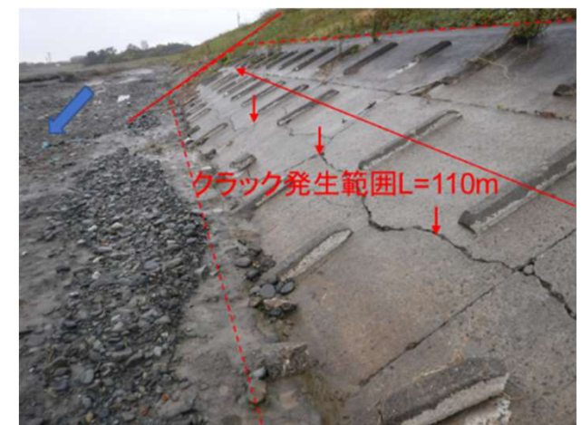
被災状況 (高水護岸崩壊)
