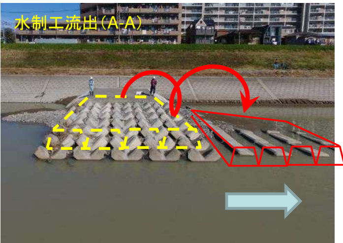
被災状況（水制工流出）
