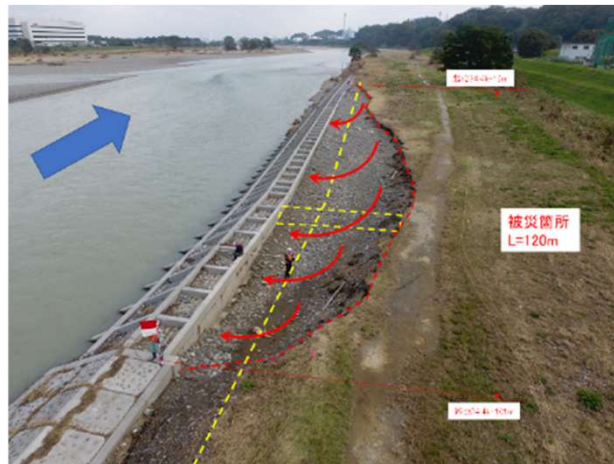
被災状況 (高水敷洗堀)
