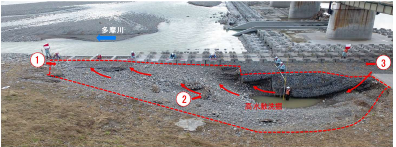
被災状況 (高水敷洗掘)
