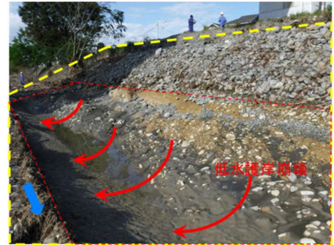
被災状況 (低水護岸崩壊)
