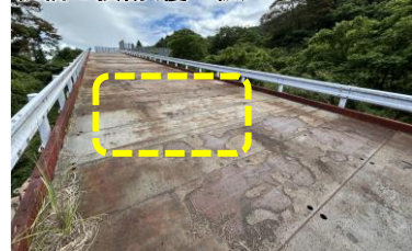
仮橋の損傷(覆工板)
