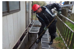
緊急(道路冠水)対応状況
