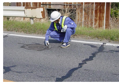
〈路面段差確認〉
