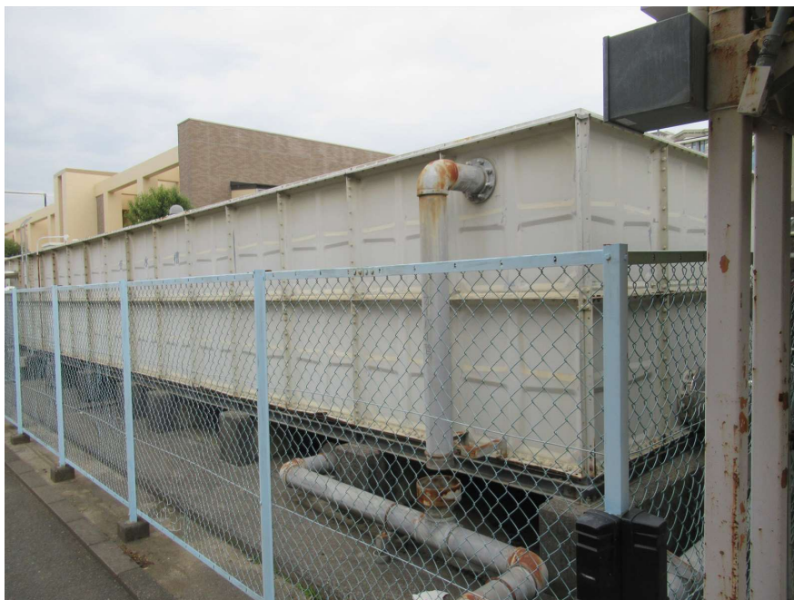
既存ポンプ室付受水タンク
