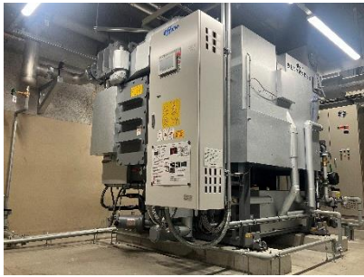
ガス焚き冷温水発生器
