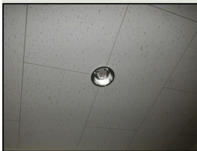
①非常照明のバッテリー切れ
