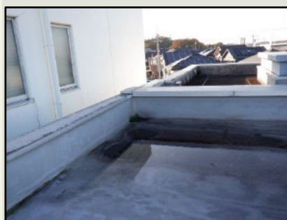
①屋上の浸水
