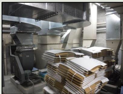
②設備機器周辺の整理
