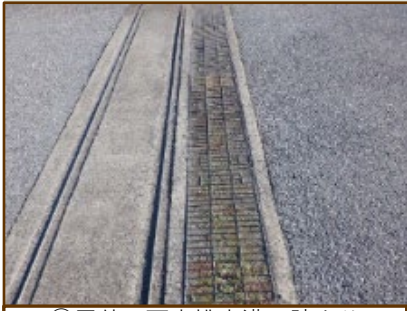
①屋外の雨水排水溝の詰まり
