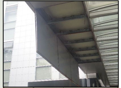
③庇仕上げ材の脱落
