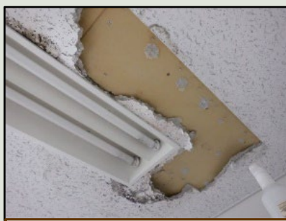
②天井仕上げ材の落下
