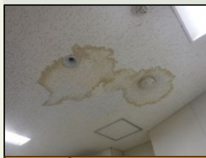
①天井に漏水跡
