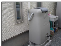
貯留槽の整備事例(富士市)
