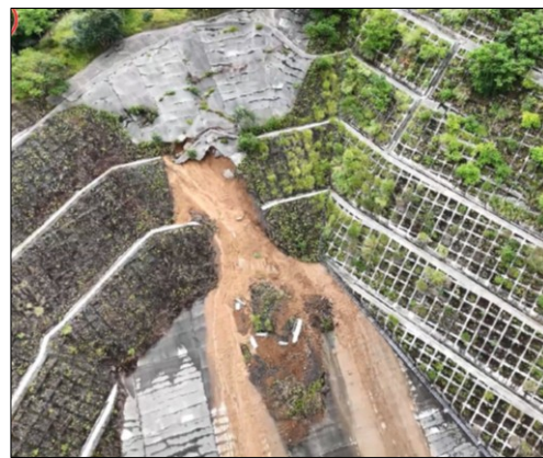
令和6年台風10号による被災状況
