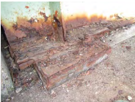
【要補修損傷箇所】
