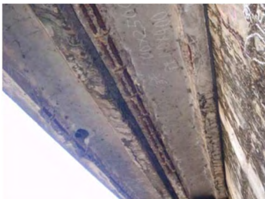
・主桁の剥離・鉄筋露出 <主桁補修>
