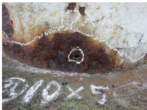
【要補修損傷箇所】
