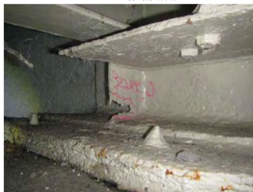
・主桁の腐食 <縦桁補修>
